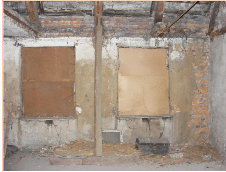
Fot. 3.7. Obszar ściany frontowej obciążony siłami rozporu więźby na odcinku brakującego stropu poddasza
