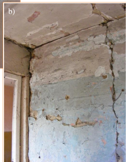
Fot. 4.6. Stan techniczny nieużytkowanych pomieszczeń I piętra: a) nadmiernie ugięty strop, odspojenia i spękania tynku sufitowego oraz zawilgocenia ściany zewnętrznej korytarza komunikacyjnego (pomieszczenie Nr 13), b) przelotowe spękania ściany wewnętrznej w pomieszczeniu nr 12
