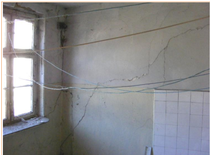
Fot. 4.9. Wylączone z użytkowania pomieszczenie Nr 19, nierówny, spękany tynk sufitowy, przelotowe, ukośne spękania poprzecznej ściany działowej wywołane rozporami więźby dachowej przekazywanymi na ściany budynku, deski podłogowe a także stolarka okienna i drzwiowa kwalifikująca się do wymiany
