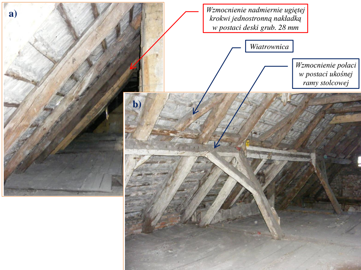
Fot. 3.4. Aktualny stan konstrukcji więźby dachowej budynku przy ul. Konopnickiej 29: a) wzmocnienia nadmiernie ugiętych krokwi połąć dachu od strony podwórza, b) ukośna rama stolcowa połąć dachu usytuowanej od strony ulicy
