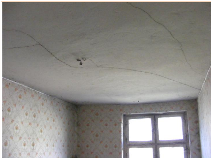
Fot. 4.8. Wylączone z eksploatacji pomieszczenie Nr 16 usytuowane od strony ulicy, nierówny oraz silnie spękany tynk sufitowy, widoczne wyraźne ugięcie stropu, stolarka okienna i drzwiowa kwalifikująca się do wymiany
