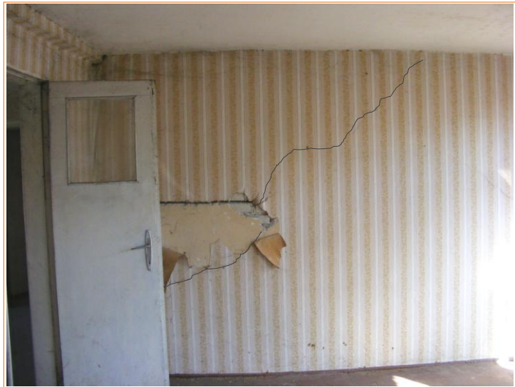
Fot. 4.7. Wylączone z użytkowania pomieszczenie Nr 15, poziome rozwarstwienie oraz ukośne spękanie poprzecznej ściany działowej będące efektem rozporu więźby dachowej, nierówny lokalnie spękany tynk sufitowy
